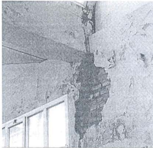
Algunos de los desperfectos que presenta el gimnasio del instituto.
