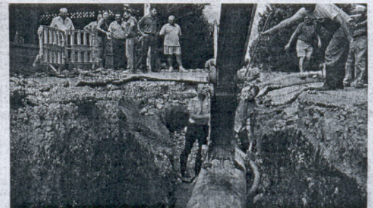
TRABAJO. Varios operarios intentan corregir el problema de
