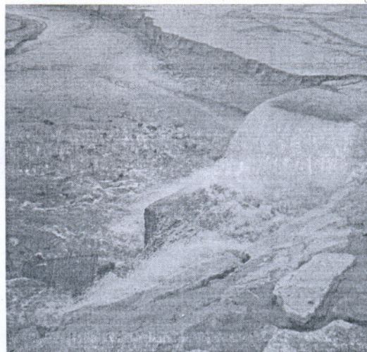
El colector de la calle Écija sigue vertiendo aguas cada vez que llueve.
