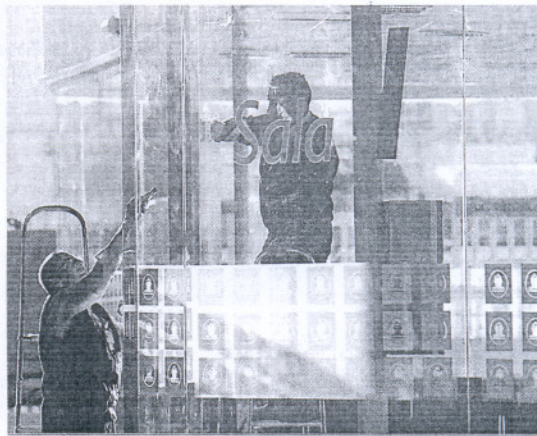
Unos operarios dan los últimos toques a la nueva instalación. JOAQUÍN PINO
