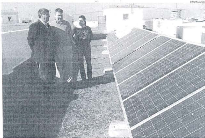
Instalaciones municipales como el edificio administrativo de la plaza de España cuentan con placas solares.
