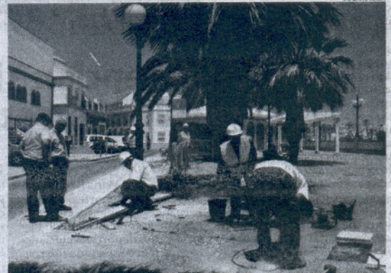
La calle Almenas necesitaba de reformas por su evidente deterioro.
